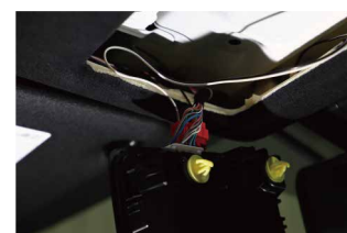
⑰フットランプ配線ハルムランプユニット裏のカバーから電源を取り出します。
